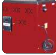
Konvektör Hava Kanalları
